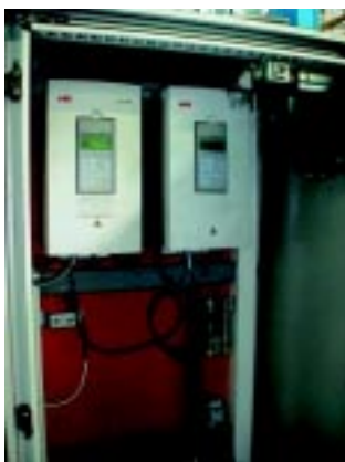
Fot. 2 Przeñoenniki w szafie
