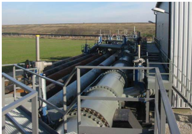
Fot. 1 Rurociągi szlamów 1400 mm i 1000 mm przy pompowni H-1
