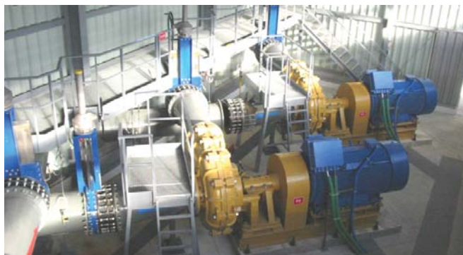
Fot. 2 Widok pomp szlamowych z silnikami EMIT
