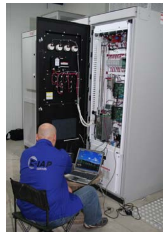
Fot. 3 Przemiennik Power Flex 7000 w trakcie uruchamiania
