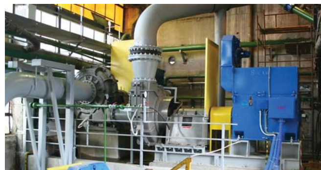
Fot. 4 Tandem pompowy w układzie technologicznym pompowni
